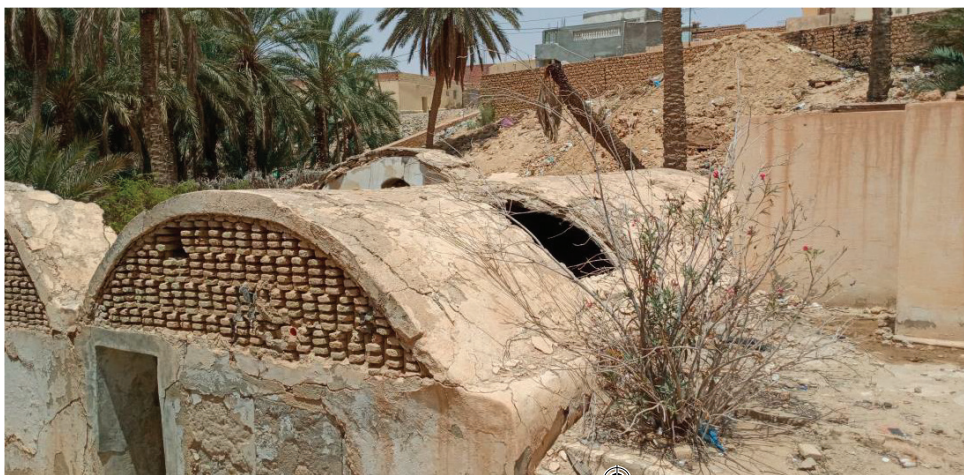
Les ruines des Hammam à Hamma
